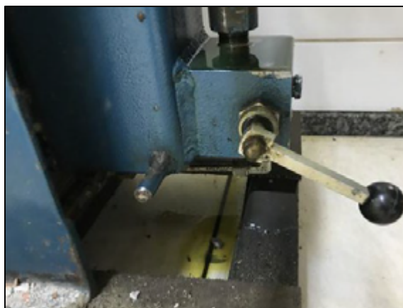
Figura 8. Vazamento de óleo hidráulico na prensa
