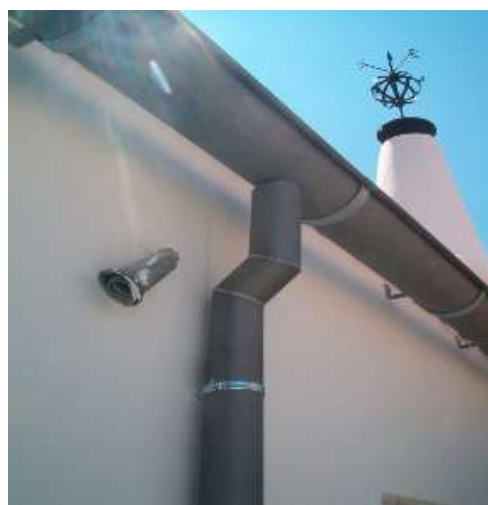
Figura 3. Tubos de queda. Fonte: Coberfuzi- Produtos (2015).
